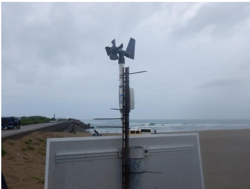
写真4 風向風速計の設置状況
