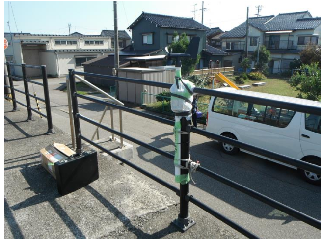
写真8 風向風速計の設置状況
