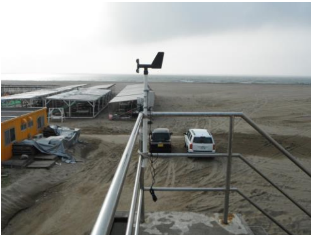
写真5 風向風速計の設置状況
