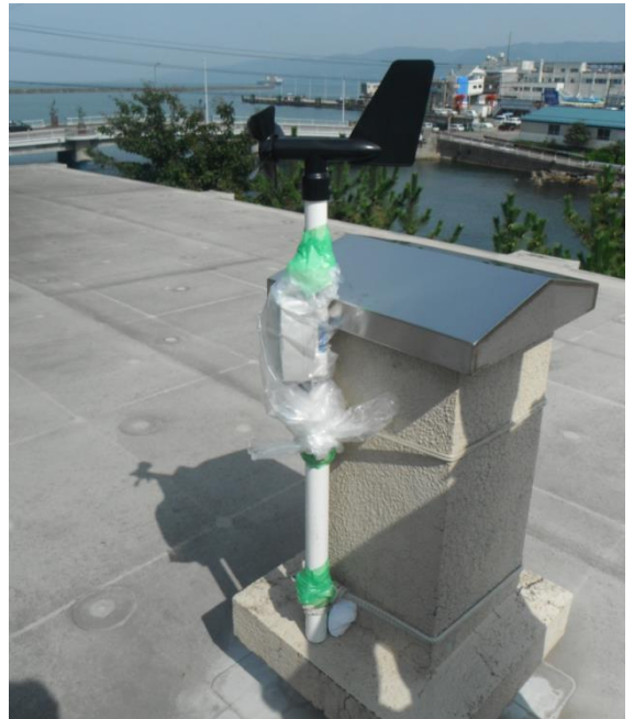
写真8 風向風速計の設置状況
