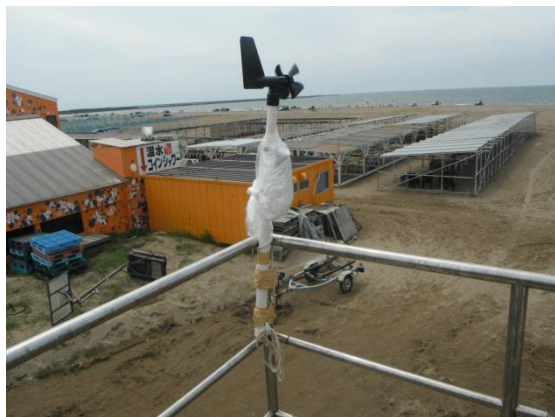
写真5 (固定式風向風速計設置状況)
